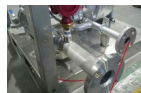
Condensate Outlet Pipe
