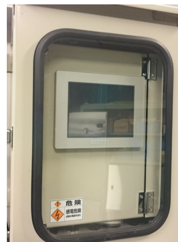
屋外仕様・制御盤
