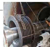
ガスタービン/発電機
