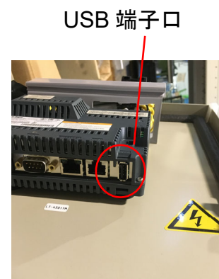
図：制御盤内部
