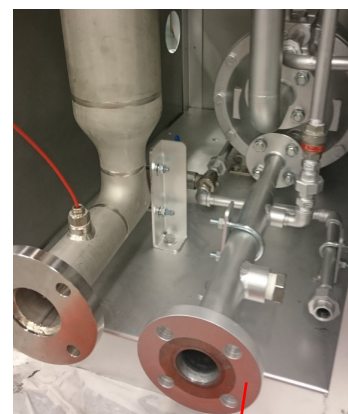
ドレン出口配管
