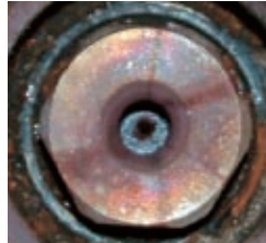
Verstopfung durch Ablagerungen
