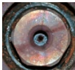
Verstopfung durch Ablagerungen
