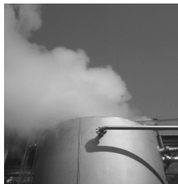
写真・2 温水タンクからの フラッシュ蒸気
