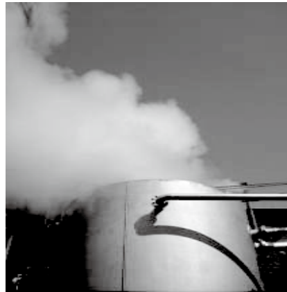
写真2 温水タンクからのフラッシュ蒸気の発生
