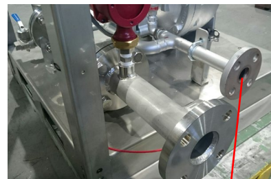
ドレン出口配管
