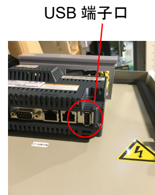
図：制御盤内部
