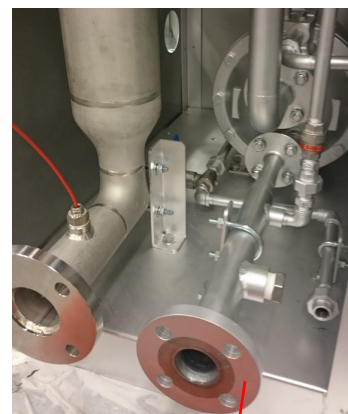
ドレン出口配管
