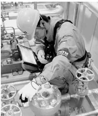
写真1 スチームトラップ診断サービスの実施風景
